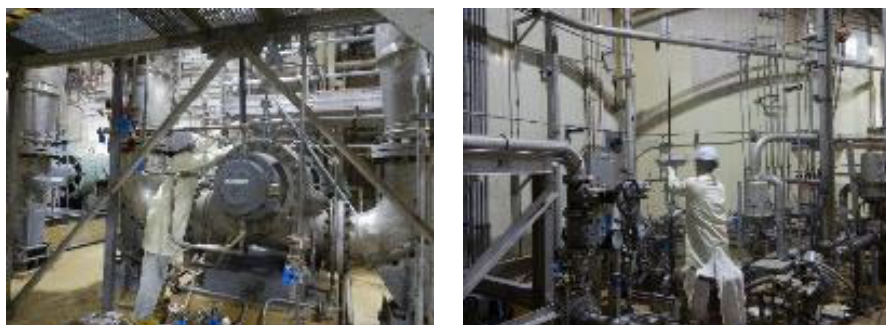
主循環系機器室計測時の様子
