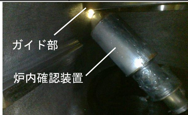
図1 炉内確認装置が仕切弁内でスタックしている状態（配管穿孔装置も同様の状態となった）
