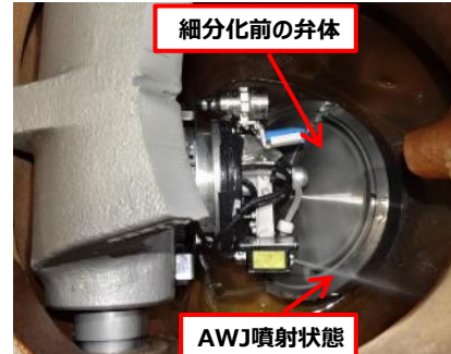
図3 弁体細分化加工状況 (解説：弁箱内洗浄により、切り落とし弁体が細分化に適した姿勢となり、AWJで細分化加工実施)
