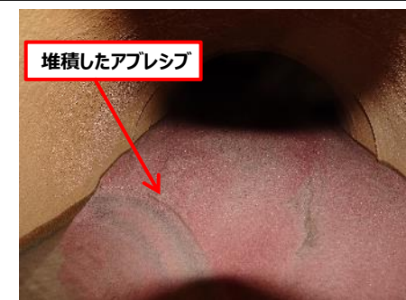
図4 配管内に堆積したアブレシブ (弁体切り落とし約70%ではあるが、逆止弁体後方に、配管内高さ約1/4までアブレシブが堆積)
