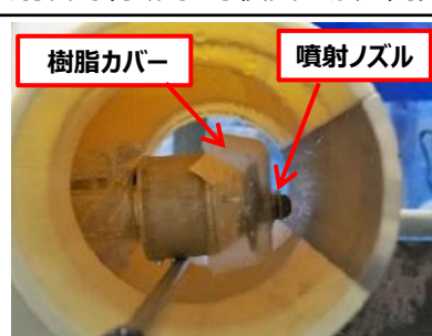
図3 高圧水跳ね返り対策 (解説: 配管内では高圧水の跳ね返りによって、ノズル回転不良となったが、柔軟性のある樹脂カバー追加とモータ電流アップで対策)
