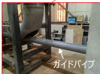
図3-1 配管エルボ穿孔部の通過 （1F現場では事前のバウンダリ構築が必要）
