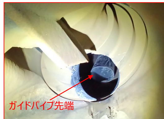
図3-2 弁体穿孔部 手前の状況
