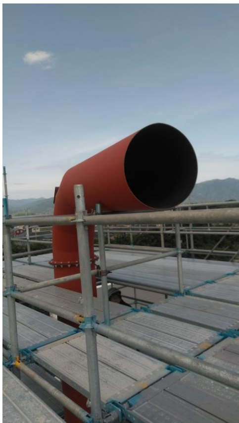
ノズル付近エルボ部
