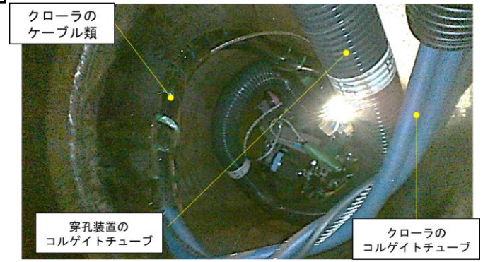
図2 スパイラル状に滞留したコルゲイトチューブの様子 (写真は配管加工ユニット)
