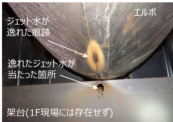
図1 エルボのRでジェット水が逸れて切断できなかったケース (配管エルボを正面から見た図)
